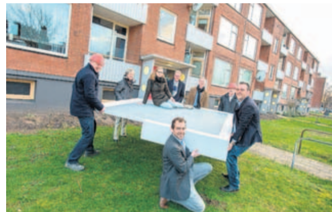
Composietbalkons zijn ideaal voor renovatie. Normteq leverde en moneerde deze voor woningcorporatie Welbions. eigen foto
